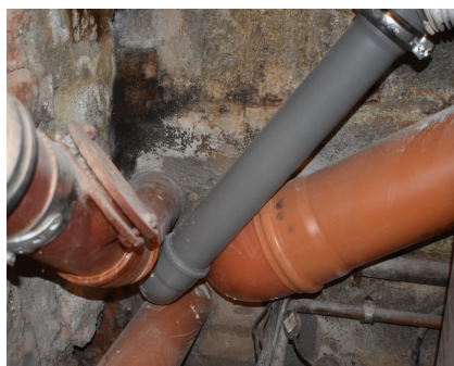
Abluftrohr (rechts) Wanddurchführung
