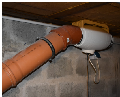
Abluftrohr mit Abluftventilator (freisaugend)
